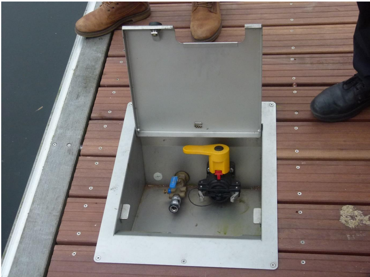
Centraal afzuigstelsysteem voor zwart- en grijswater bij Jachthaven de Eemhof in Zeewolde
